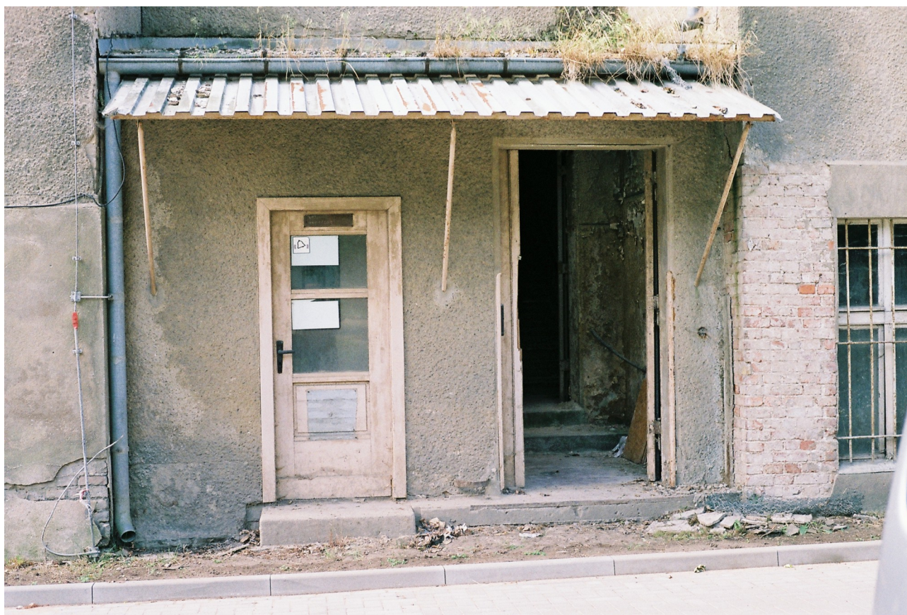
Den demolerade entrén till sanatoriet Heidehaus – här bör Fallada ha passerat åtskilliga gånger.
